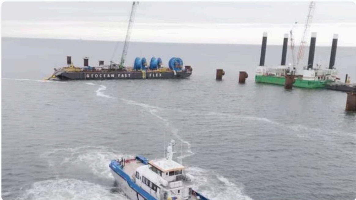
Geocean a utilisé l'un de ses concepts d'aménagement modulaire de barges pour le projet de connexion à la côte du FSRU associant Engie à TES à Wilhelmshaven (Allemagne). | GEOCEAN
